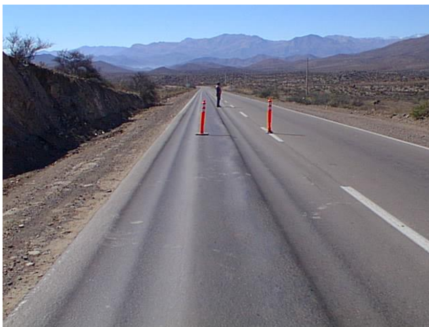
Fotografía N°1 Ahuellamiento en un camino del norte de Chile.
